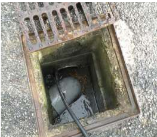
Avaloir d'eau pluviale
